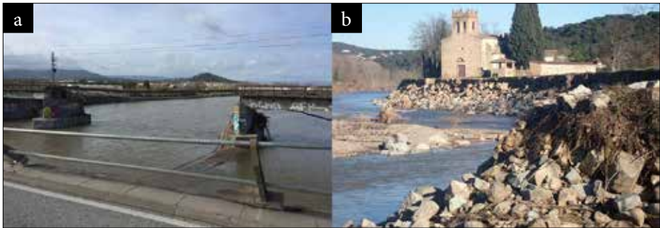
FIGURA 6. (a) Restes (pilars i part del ferm) del pont ferroviari de la línia 1 que creua la Tordera entre Malgrat de Mar i Blanes. (b) Soscavament de l'escullera del marge dret de la Tordera a Sant Cebrià de Fogars, a la Selva.
